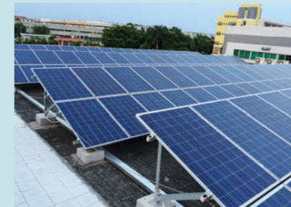
設置された太陽光発電システム
